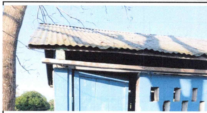
Foto 2: Se observa la puerta de la cocina deteriorada, ya no se puede cerrar, por faltas de algunas partes.
