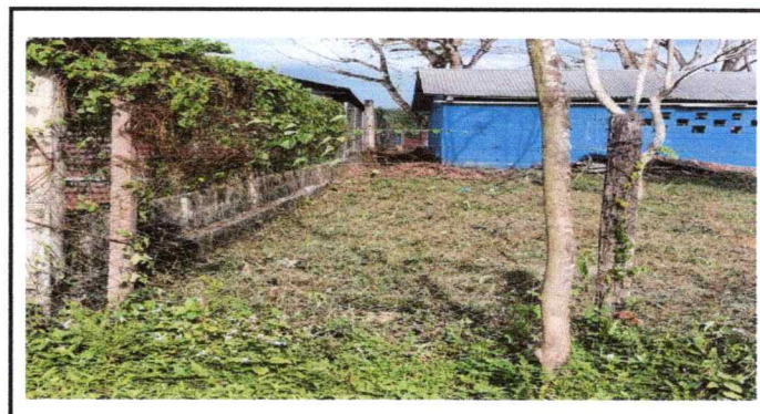
Foto 4: Se observa la malla perimetral esta deteriorada y necesita mantenimiento
