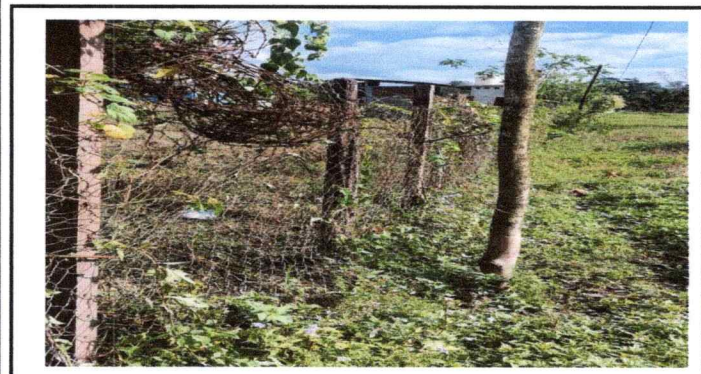
Foto 3: Se observa el deterioro de la malla perimetral, esta muy oxidada.
